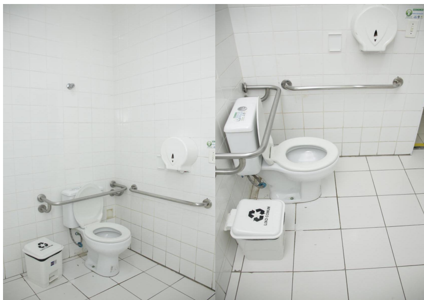
Figura 18 – Vasos sanitários com caixas acopladas
