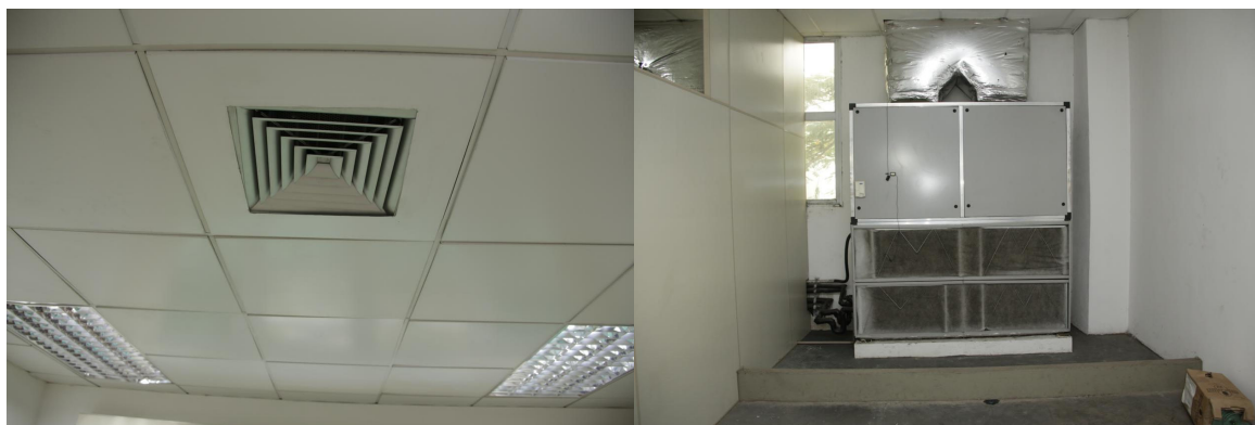
Figura 22 – Ar condicionado central da Câmara Municipal de Barueri
